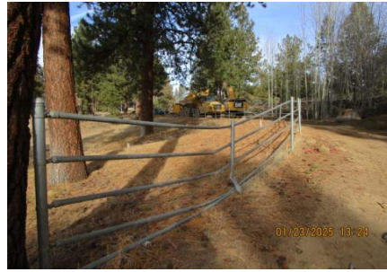
AID MCPH2 Seg2 - Sta. 842+75 damage existing fence 01-23-25
